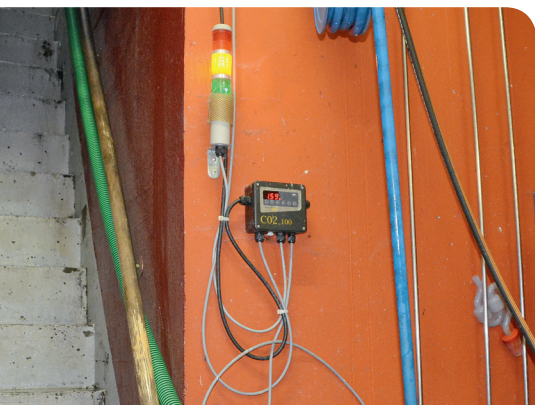
Les appareils de mesure surveillent en permanence le taux de CO 2 dans l'air et donnent l'alerte en cas de danger.
