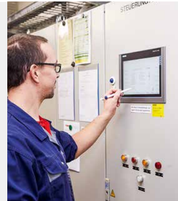
Steuerung der Raumtemperatur
