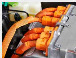
Orange Leitungen als Hinweis auf Hochvoltssysteme
