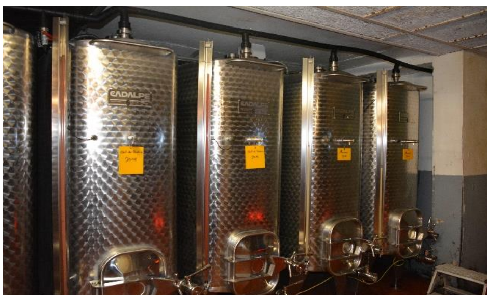
Installation de captage à la source sur une batterie de cuves inox.
