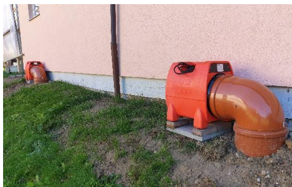
Ventilateurs ayant un débit de 3000 m 3 /h. Un aspirant de l'air vicié et l'autre insufflant de l'air frais.
