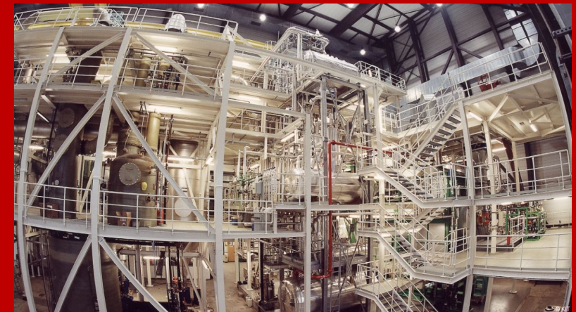
Versuchsanlage zur Thermischen Entsorgung Spezieller Abfälle (THERESA) am KIT
